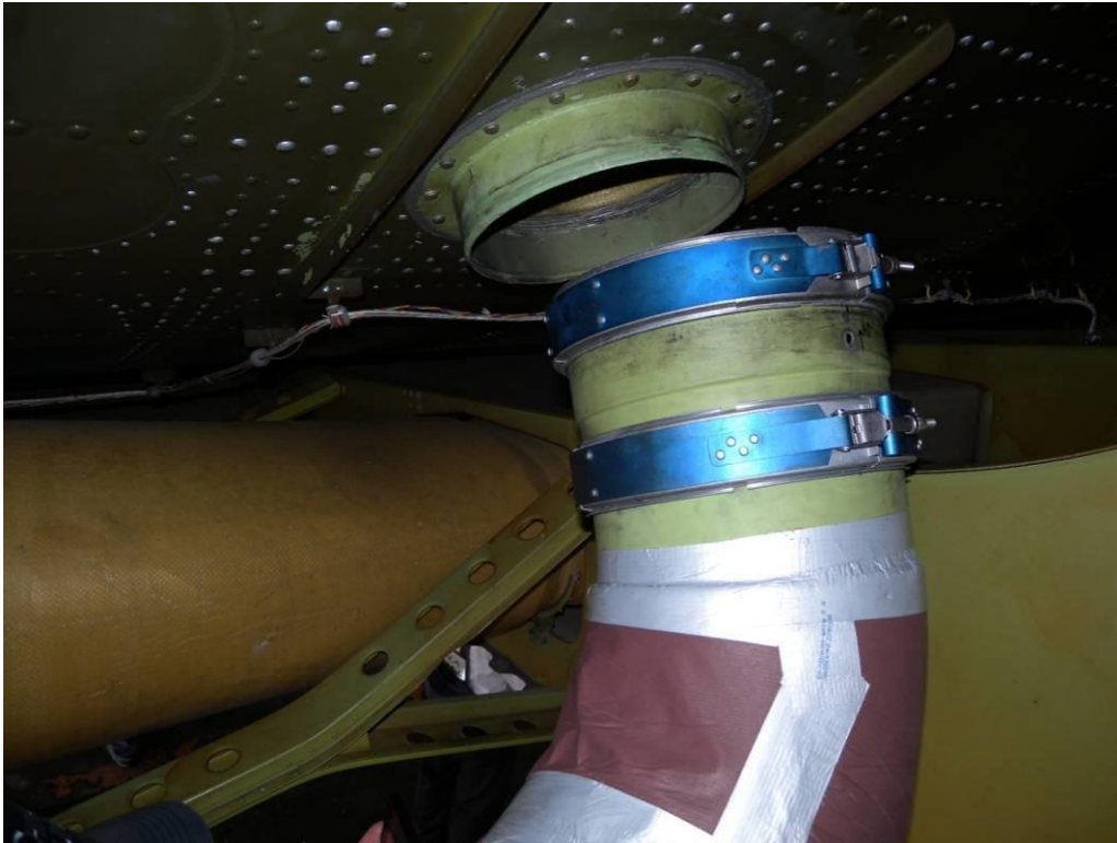
圖 1.16-1 脫落之 3 號空調機空調管
