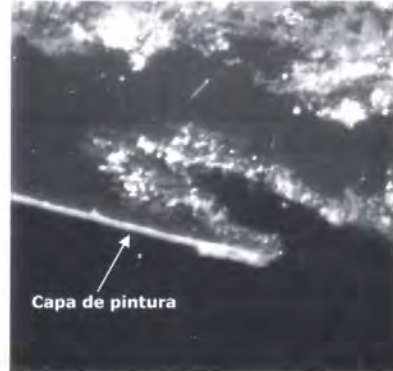
Figura 5. Muestra correspondiente a una zona del Trailing edge (bajo lupa). Se observa el avance del deterioro según la dirección de la cuerda de la sección, haciéndolo por debajo del área superficial pintada. La capa de pintura en la zona señalada por la flecha aparece sin daño mostrando que el avance de la superficie corroída proviene desde el extremo derecho.
