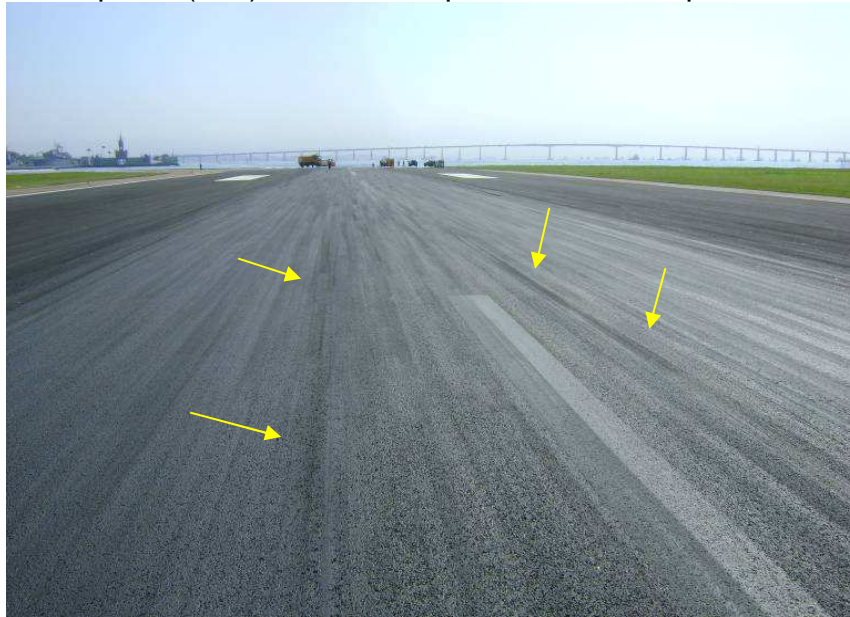
Figura 01: Marcas de derrapagem a 220m da cabeceira 20L.
