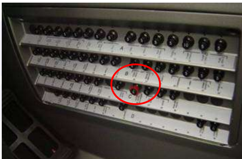
Figura 1 – Painel dos circuit breaks do lado direito.
